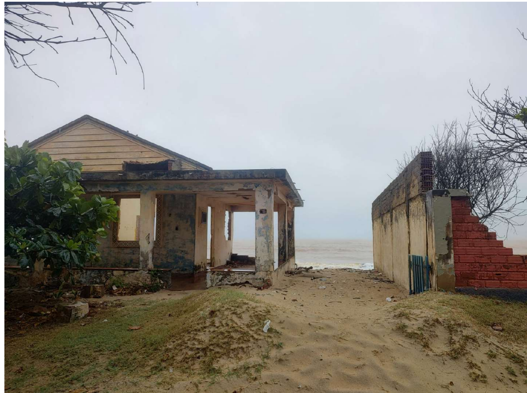
Figura 20: Casas em Atafona destruídas pela ação do mar Fonte: o autor
